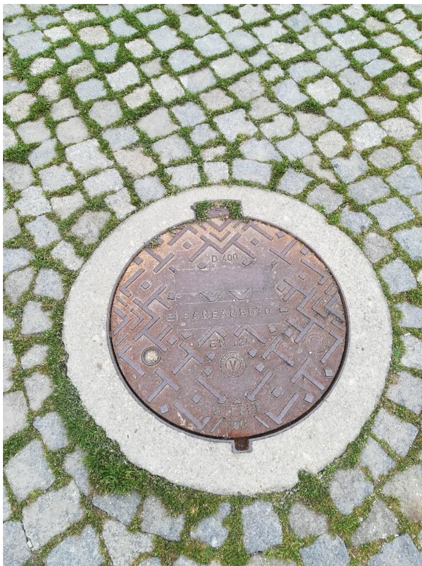
Figura 38: Fossa de águas residuais domésticas.
