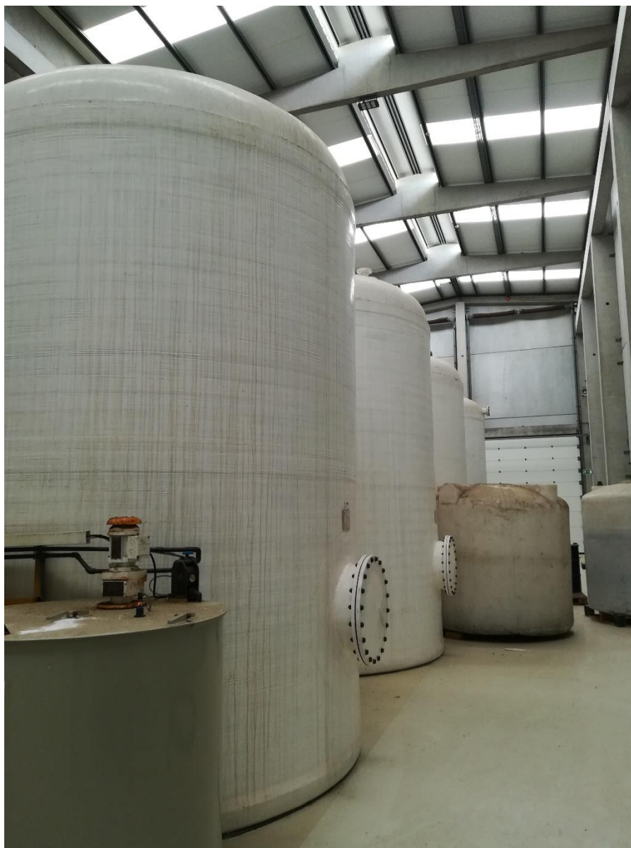
Figura 39: Tanques de armazenamento de águas residuais industriais.
